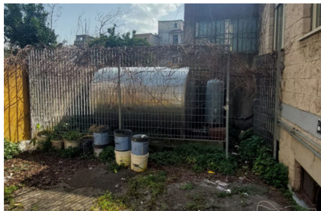
Figura 4 – Serbatoio per accumulo acqua.
