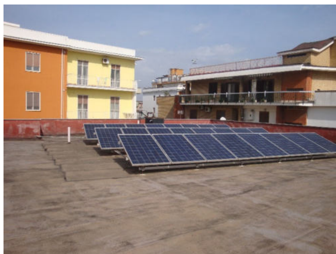
Figura 2 – Pannelli fotovoltaici in copertura.
