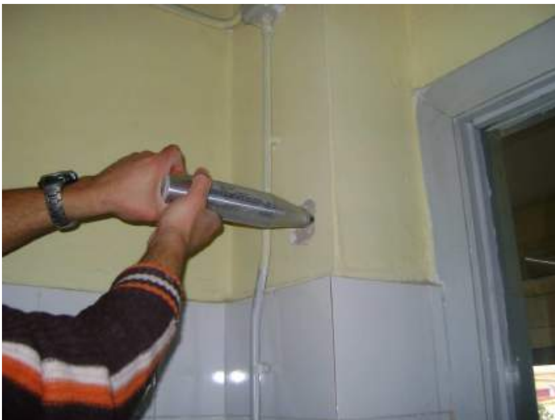
Figura 66 – Sclerometria pilastro P/PT/11
