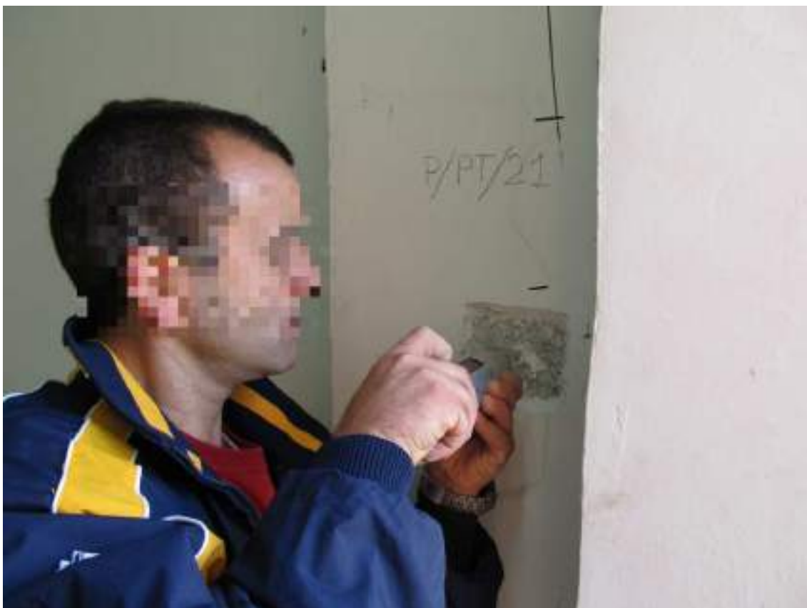
Figura 68 - Sclerometria pilastro P/PT/21
