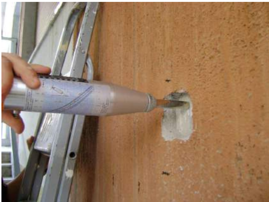
Figura 62 – Sclerometria pilastro P/PT/17
