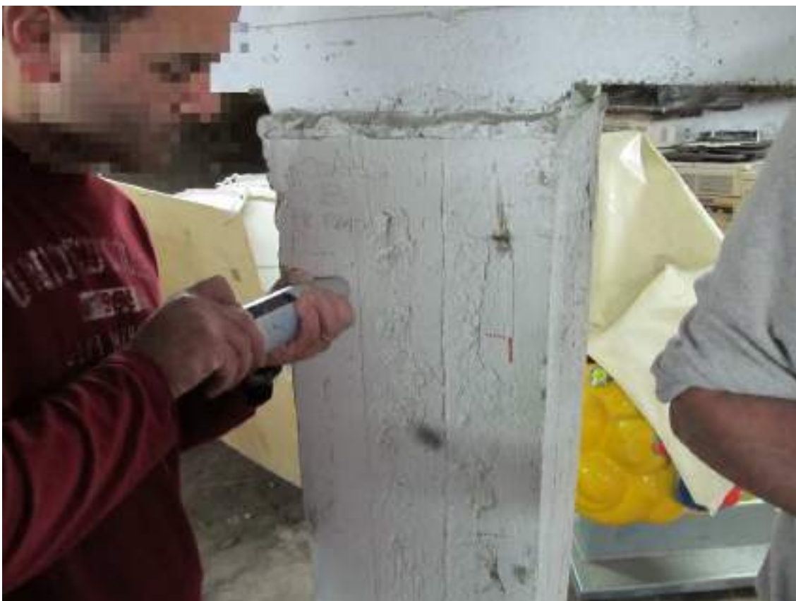
Figura 84 - Sclerometria pilastro centrale Corpo B - PS
