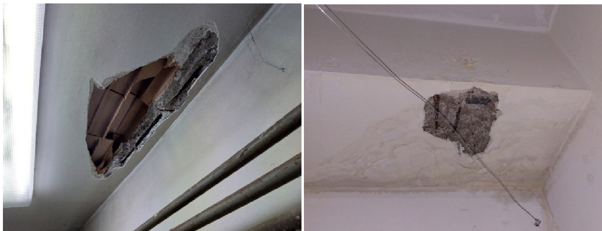
Figura 13 – Fenomeni di carbonatazione del calcestruzzo ed ossidazione delle armature rilevati.
